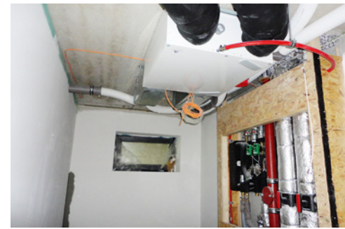
Entspricht die Ausführung der Planung und den ausgeschriebenen Materialien?
