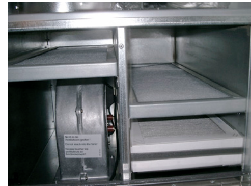
Filter in einem Lüftungsgerät
