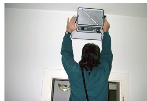
Messung des Volumenstroms eines Zuluftventils bei der Einregulierung der Anlage
