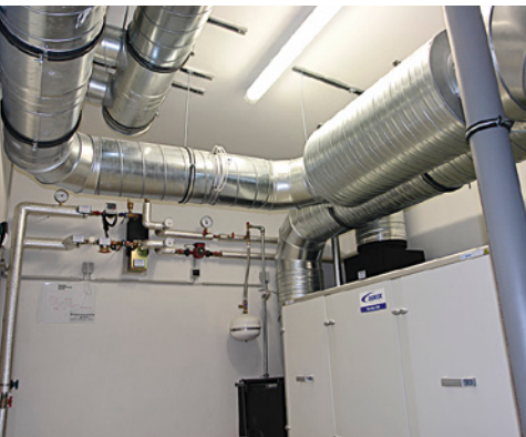
Lüftungszentrale für 15 sanierte Wohnungen
