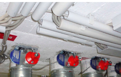
Von oben nach unten: Lüftungsleitungen mit Feuerschutzmantel Brandschutzklappen an der Decke der Lüftungszentrale im Keller
